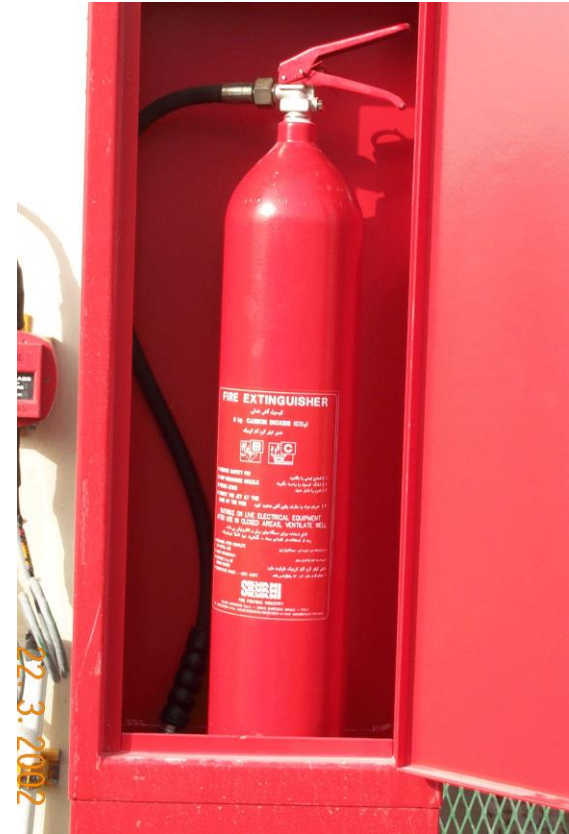
CO2 Type Extinguisher
